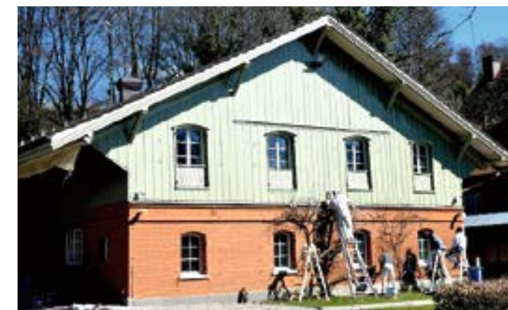
Das Clubhaus nach dem Renovation. Die Maler nehmen letzte Retouchen vor. // Bild Eugen Desiderato
